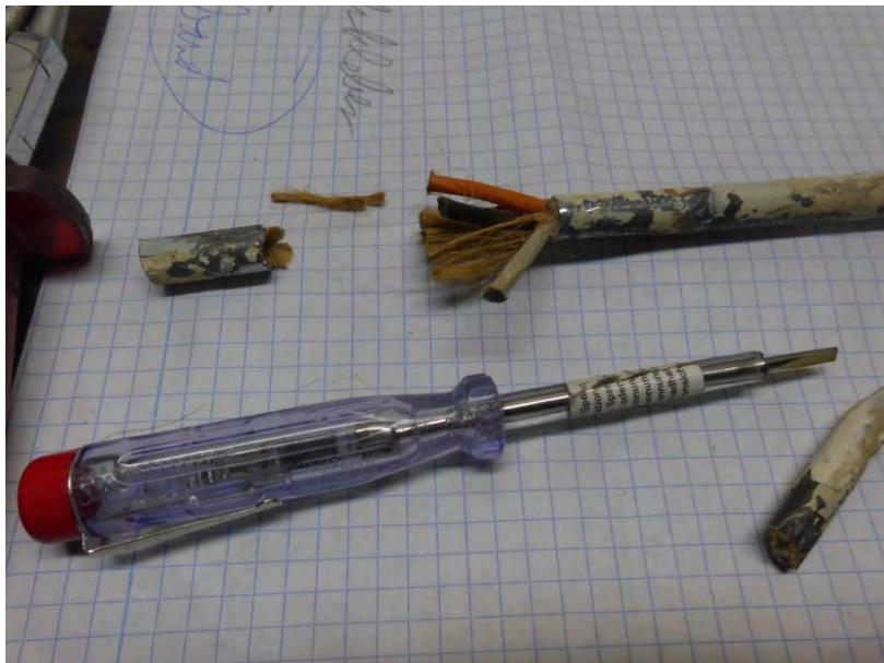
Bild 5: Kabelende mit drei farbigen unterschiedlichen Adern-Farben
