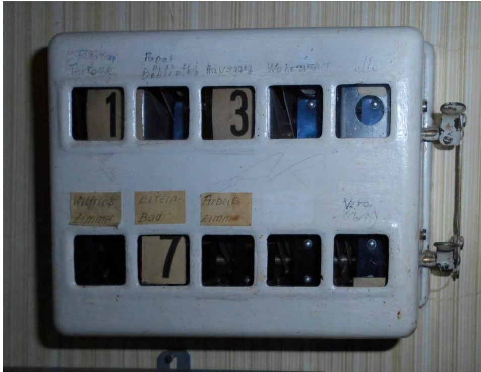
Bild 11: Anzeige der Dienstbotenklingel-Anlage in einer Küche (August 2017)
