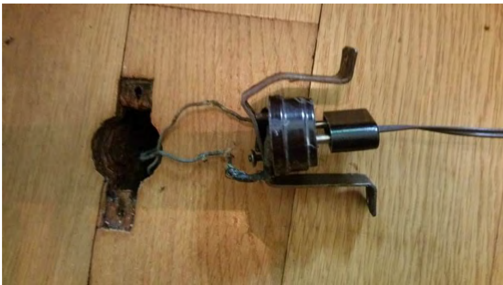
Bild 14: Mini-Steckdose im Fußboden für einen mobilen Dienstbotenklingelknopf
